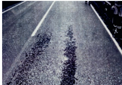
Bilde av separasjonsskade.
