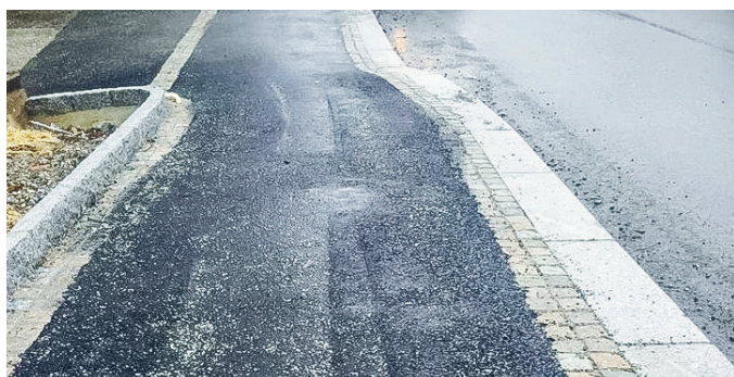
Uheldig og unødvendig med valespor.
