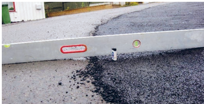
Ingen god utførelse av arbeidet.
