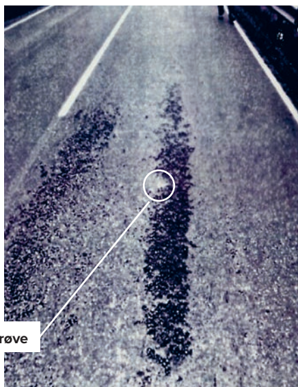
Bilde av separasjonsskade samme sted i 1990.
