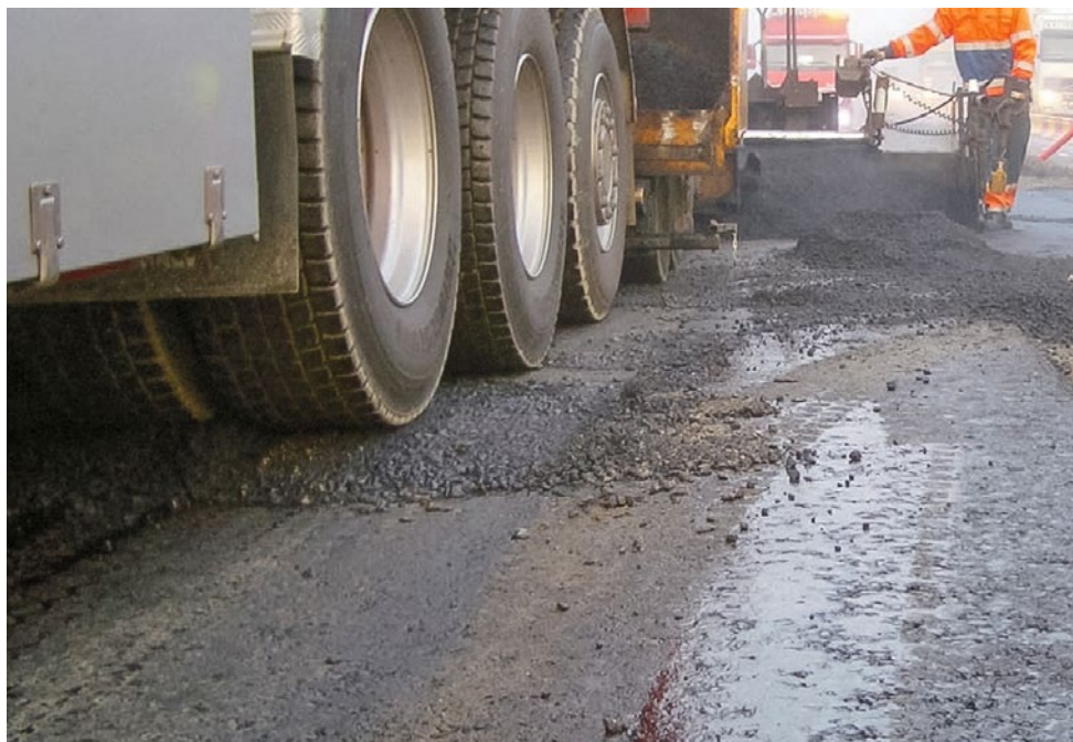
Ingen god utførelse av arbeidet. Er du som byggherre til stede?
