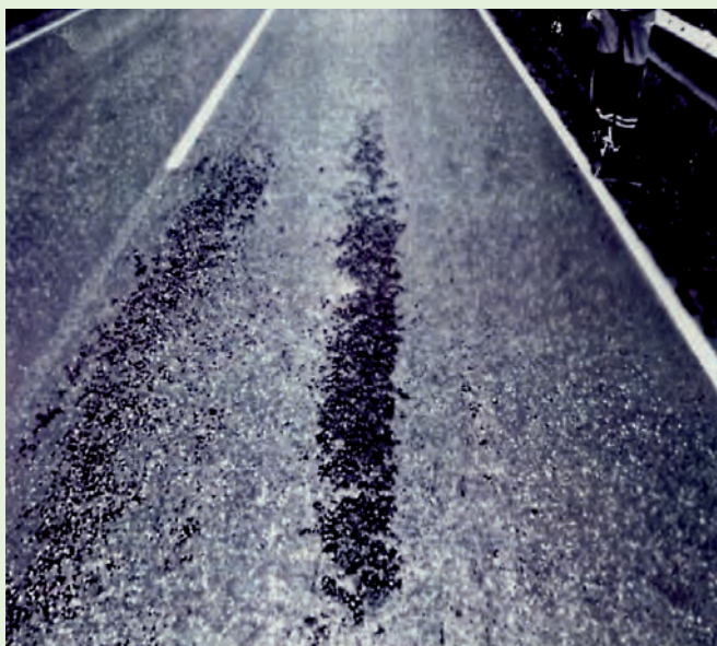
FIGUR 1. Bilde av separasjonsskade.
